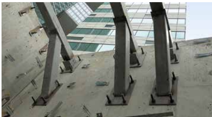
Крепление опор промышленных кондиционеров (Многофункциональный комплекс IQ-quarter в составе Москва-Сити, г. Москва, 2018 г.)
